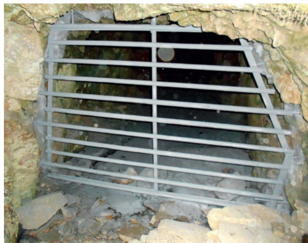
La grille permet de sécuriser l'entrée d'une ancienne galerie, adaptée à la taille des chauves-souris
